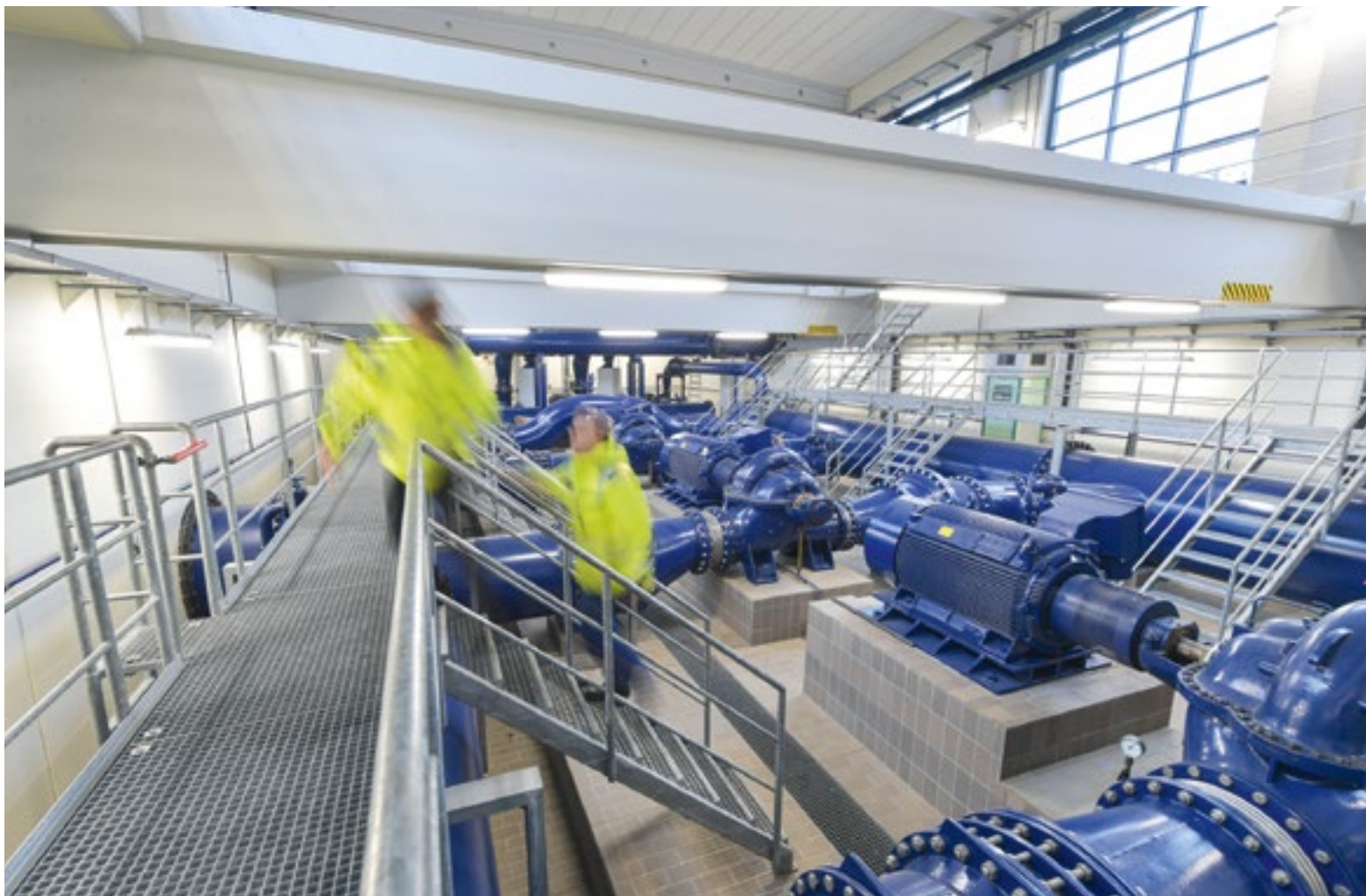
Rheinwasseraufbereitungsanlage Biebesheim, Netzpumpen
