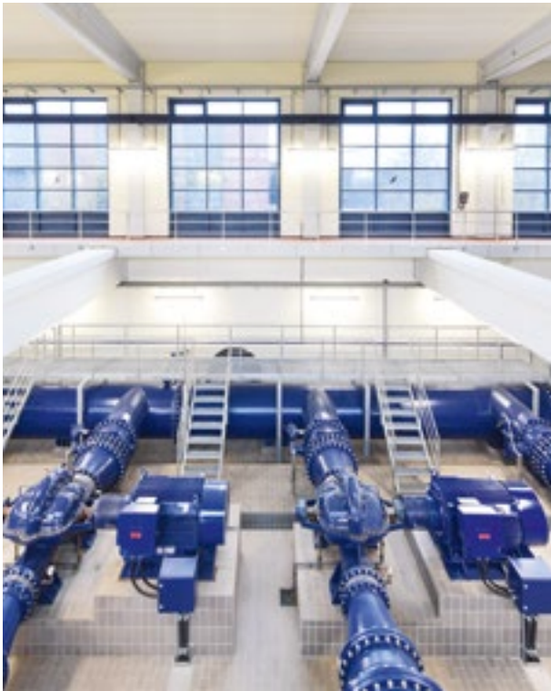
Pumpenhalle der Rheinwasser- aufbereitungsanlage Biebesheim
