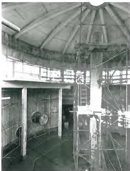
Innenansicht des Rohrverteilungs- bauwerkes in der Mitte der vier Wasserbehälter in Haßloch
