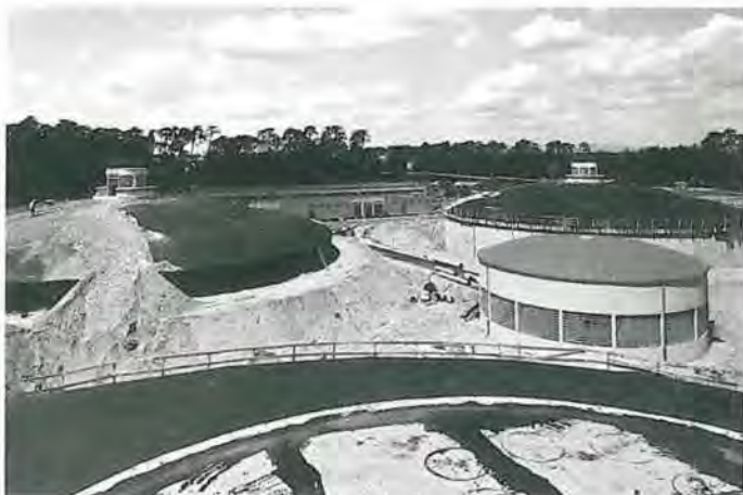
Gesamtansicht Verteileranlage Haßloch
