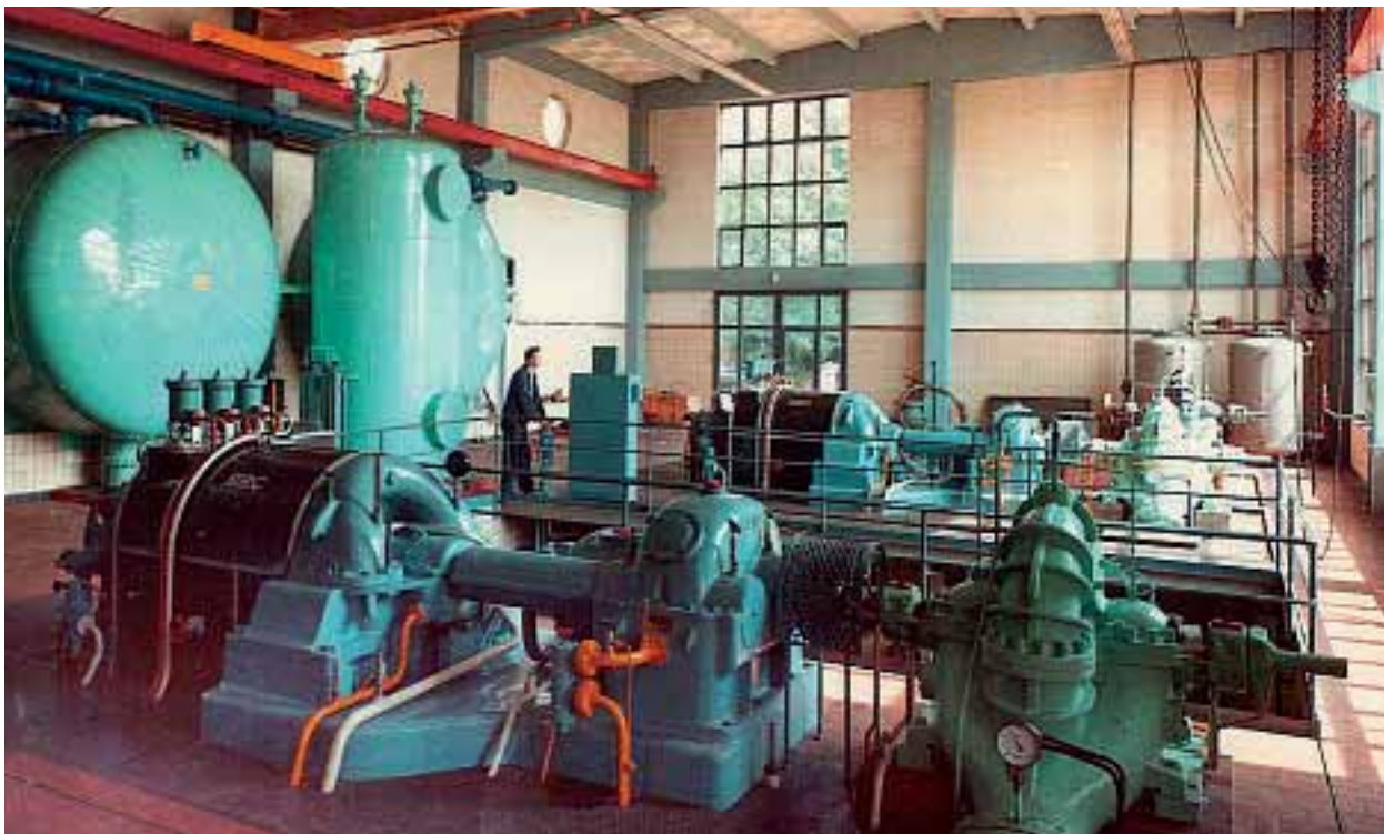
Blick in die Maschinenhalle mit Turbopumpen und horizontalen Enteisungsfiltren, Fotografie um 1963
