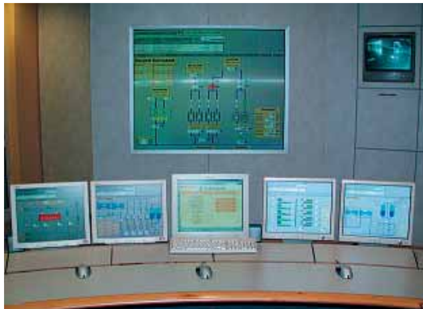
Die neue Leitzentrale 2002
