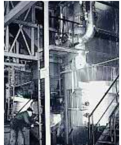
Kesselhaus mit Heizer bei der Arbeit
