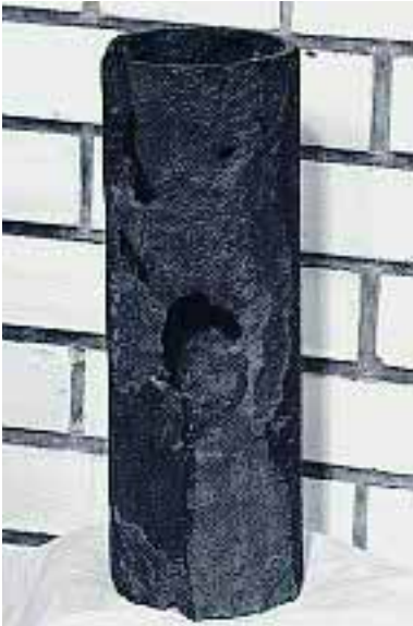
Typische Schadensbilder an eisernen Wasserrohren: Rostfraß
